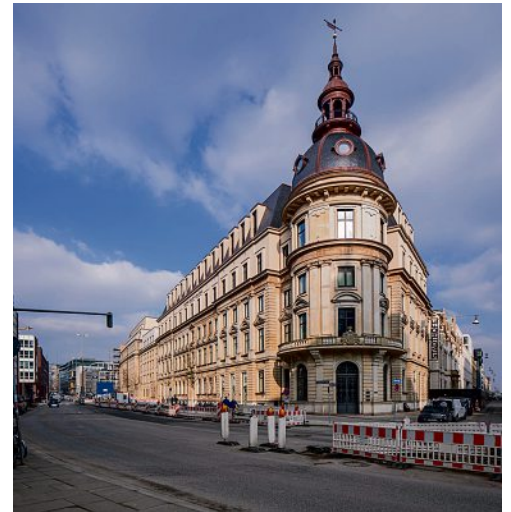
Stadthöfe Hamburg – Umbau Palaishaus; Architekten: Kuehn Malvezzi (LP 1 bis 4 und gestalterische Qualitätssicherung LP 5 bis 8), agn Leusmann GmbH (LP 5); Foto: © Carsten Brüggemann
